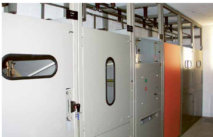
Konventionelle, luftisolierte Anlage
